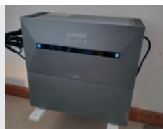
Wechselrichter und Speicher
