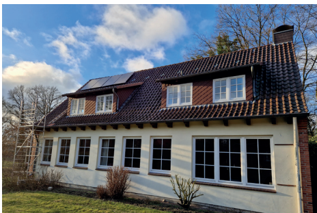
Gemeindehaus mit neuem Balkonkraftwerk
